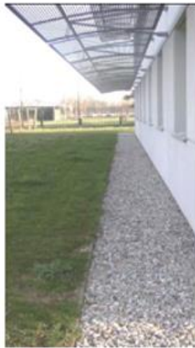
Tranchée drainante (Source : SIAVB)
